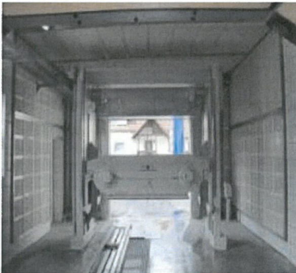
Lärmschutzverkleidung in Waschhalle
